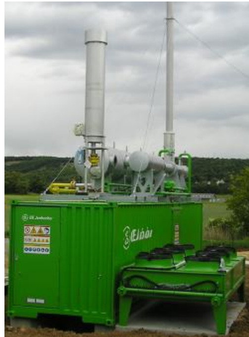
Abbildung 8: BHKW mit Fackel und Tischkühler
